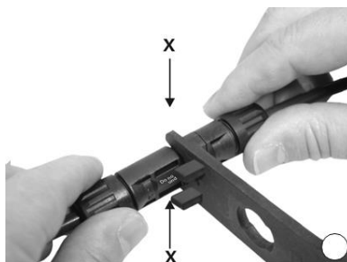
Figura 26 - Desconexão do MC4 para manutenção.
